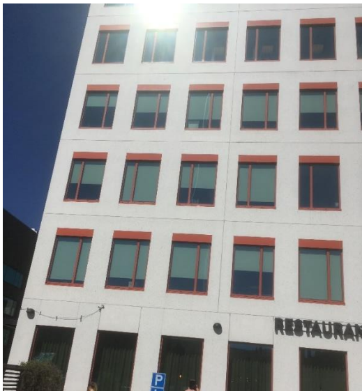
Figur 17. Söderfasad (väderstreck åt söder ca 165°). Mätslang monterad i fogkryss via TDV-öppning (plan 2).
