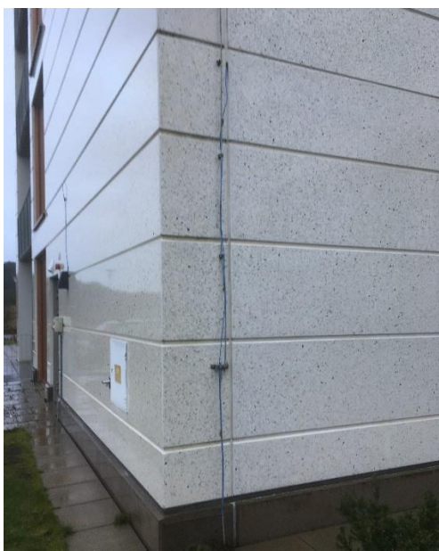
Figur 13. Objekt 2, österfasad med mätslang (blå) placerad i vertikal fog via TDV-rör. Till vänster på bilden är gavel åt söder.
