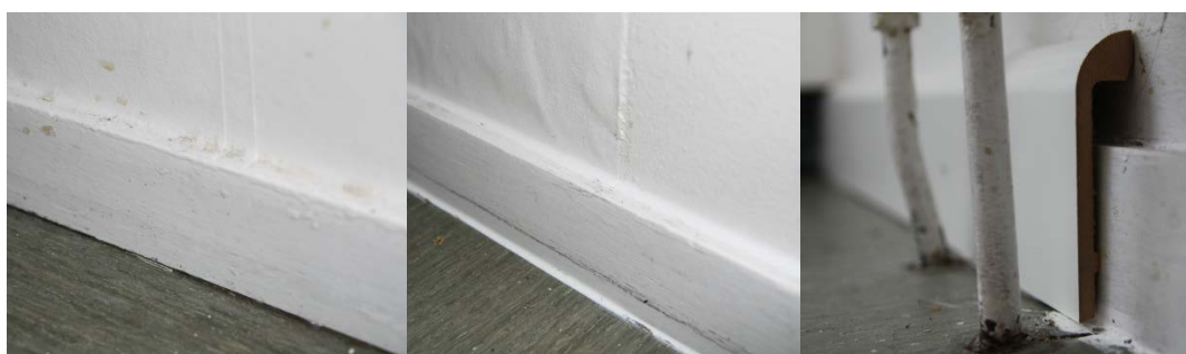
Figur 3.1 Vänster: gammal golvlister i befintligt skick. Mitten: gammal golvlister efter fogning. Höger: del av Renoveringssockeln monterad.
