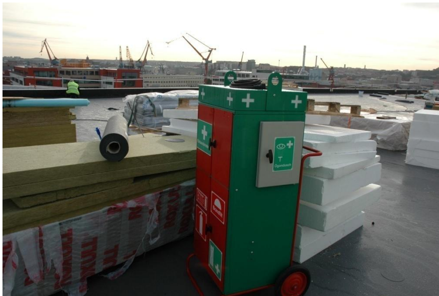
Bild 5. SafetyCabinet på taket Lindholmospiren Göteborg.
