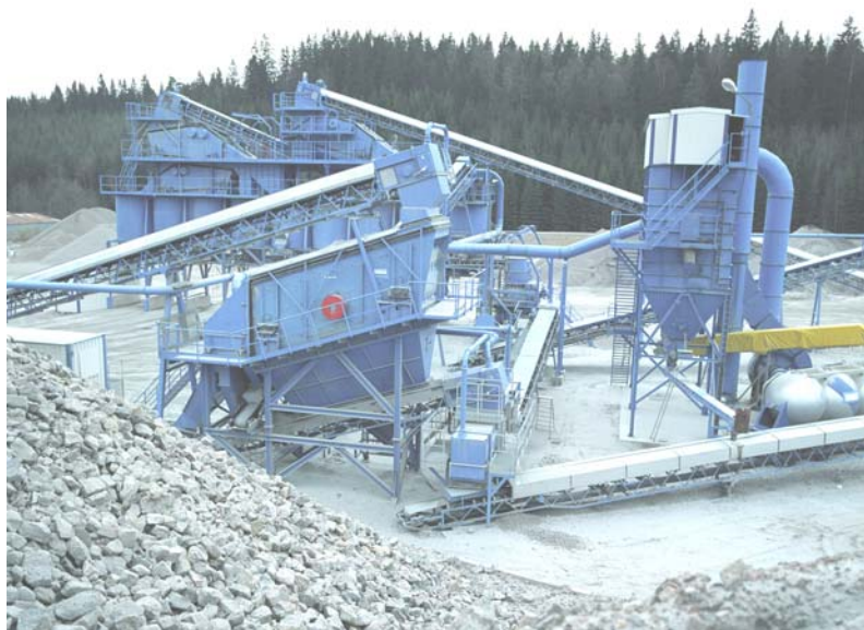
Figur 1. En del av en krossanläggning för produktion av ballast (publicerad med tillstånd av Sandvik Rock Processing)
