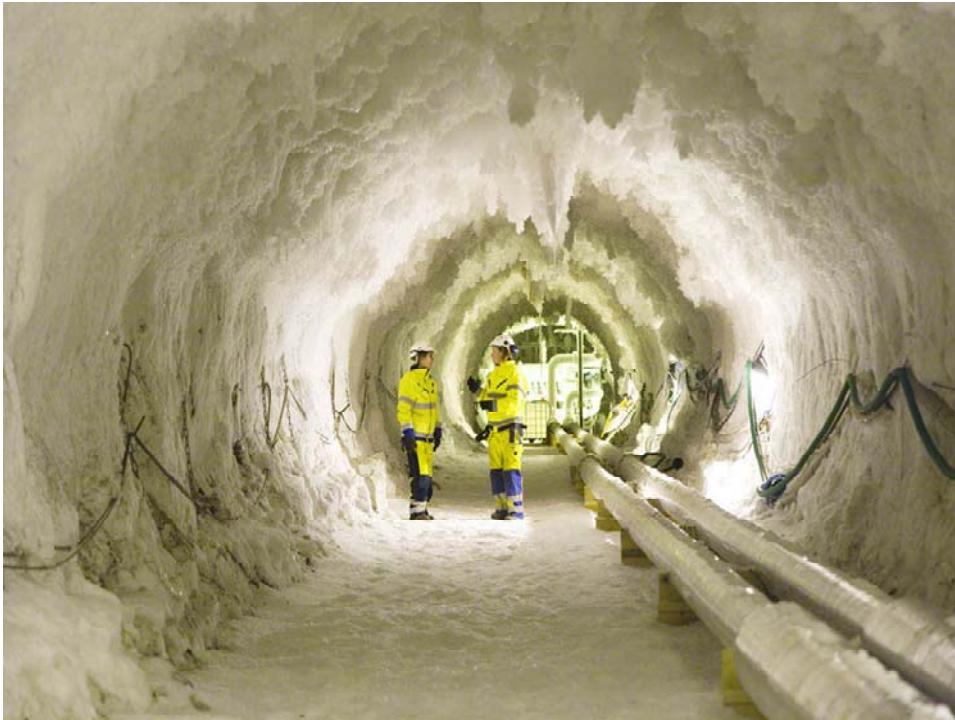
Bild från pilottunneln 2009 genom den mest kritiska delen av Möllebackszonen där försök till provtagning utfördes direkt efter utsprängning 2007. Tunneln omges av "frysör" strax utanför den utsprängda tunnelsektionen.
