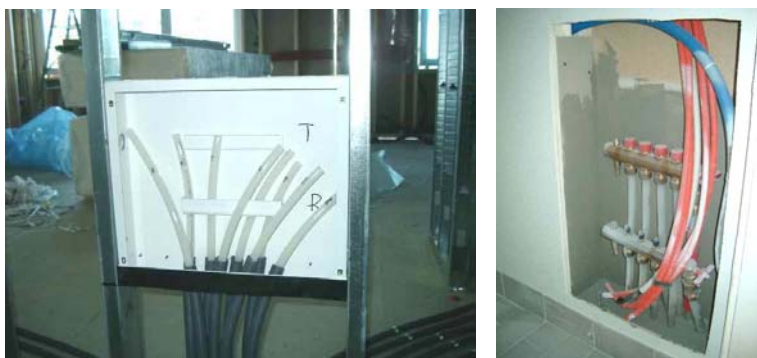
Bild 9.2,3: Olika utförande på läckagevarning av kopplingsplint med PEX-system. Till vänster specialsåp och till höger har man gjutit upp och tätat kring rör genomföringarna.
