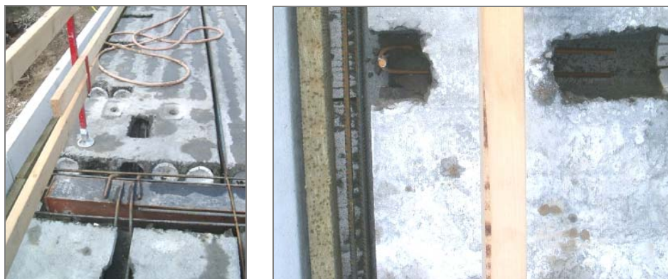
Bild 5.1, 2: Upplagda HD/F-plattor innan foggjutning. Notera i bilden till vänster de två yttersta kanalerna mot yttervägg som har rasförankring vilket skär av kanalerna med igjutningar varannan meter. Här krävs det många dräneringshål för att få säkerställd dränering. Bilden till höger visar rasförankring när bjälklaget bär på yttervägg.
