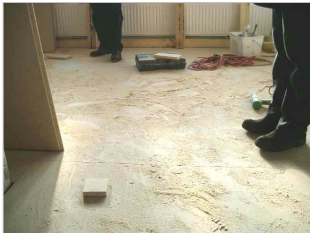
Bild 9.1: Kvarliggande sågsån på uppreglat spånskivegolv. Hur mycket kan ha ramlat ned vid väggarna?
