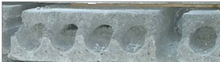
Bild 6.2: Betongrester i kanaler vid K-ändar. Tätning av kanalernas ändar måste finnas för att hindra betong att rinna in och sätta igen dräneringshålen vid igjutning. Tätning kan ske med cellplastplugg eller betong. Jämfört med cellplastpluggen innebär alternativet med betongplugg att dränering av kanalen inte kan ske i tidiga skeden via kanalände. Vid utförande med betongplugg är det viktigt att hela hålet tätas.
