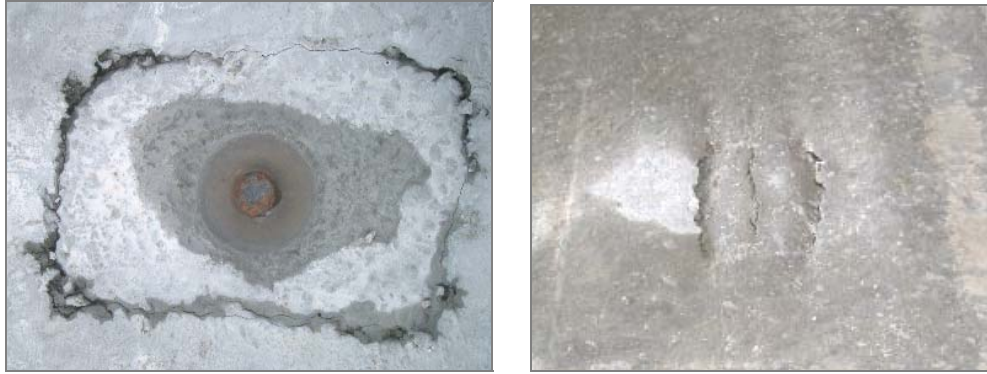
Bild 6.3,4: Sprickbildning i HD/F-plattor. Bilden till vänster visar sprickbildning kring injutet lyftankare. Bilden till höger visar sprickbildning över kanal som man kan få om man har problem med betongkonsistensen vid gjutningen av elementet. Finns sprickbildningen bör dräneringshålen kompletteras kring sprickan.
