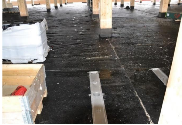
Kanske onödigt mycket avvattningsbrunnar och -rännor
