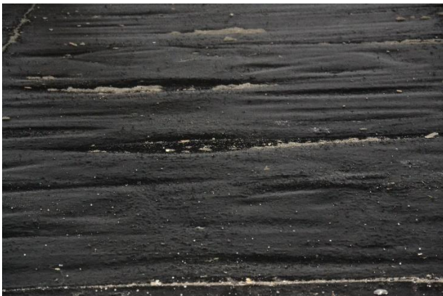
En del blåsbildning har uppstått i första lagret gjutasfalt
