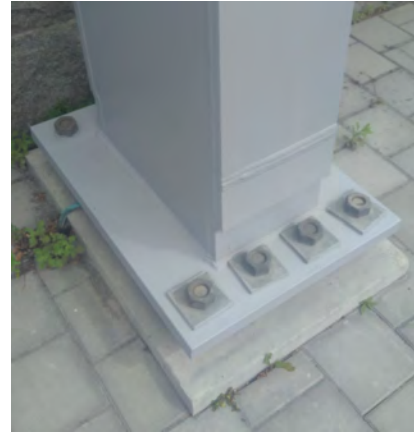
Figur 4.1 Pelare till skärmtak på järnvägsstation i drift. Grundbultarna avslutas i muttrarna. Brickor saknas delvis. Ingen undergjutning. Pelaren för kort, löst på plats? Utförandekontroll?
