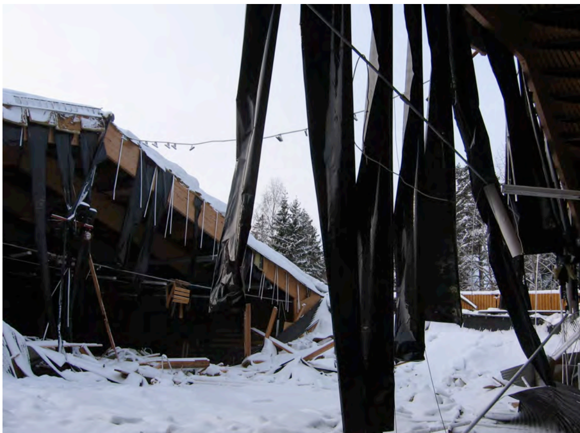
Figur 4.3 Ishall byggd i mitten av 1980-talet, dimensionerad enligt SBN 80. Skadan inträffade i februari 2013 vid en relativt låg belastning i förhållande till dimensionerande last och uppstod genom att takplåten gled isär vidnock vilket fick takåsarna att brista och takbalkarna att tappa sin stegning i sidled. En vanlig lösning för att staga upp takåsarna mot belastningen från takplåten i takfallets riktning är att en så kallad skjuvregel fästs på takbalkarnas översida mellan två takåsar på respektive takbalk. Utredning visade att sådana skjuvreglar saknades och att den ursprungliga nockplåten bytts ut sommaren innan skadan inträffade. Sannolikt höll den tidigare nockplåten ihop taket och fördröjde därmed konsekvenserna av ett ursprungligt fel i nästan 30 år.
