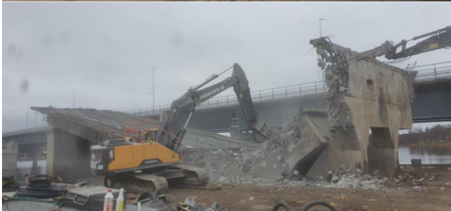
Figur 8.6. Rivning av ändspannat på Lulesidan, jämför Figur 6.8. Överst: Ramp byggs. Mitten: Den nya bron syns till höger och det rivna spannet till vänster. Nederst: Det gamla rivna spannet i förgrunden och den nya bron i bakgrunden.
