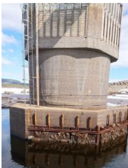
Figur 3.18 Utskovstorn i en vattenkraftanläggning.
