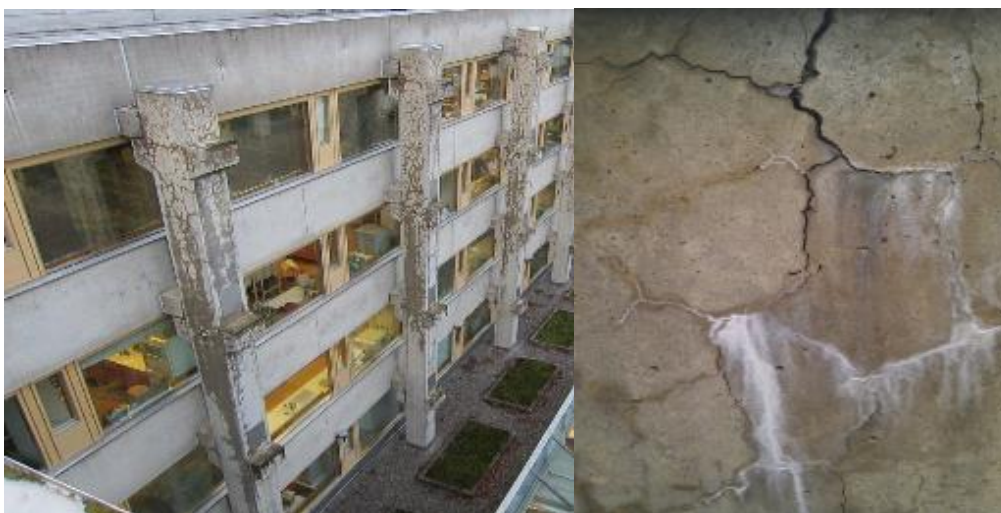
Figur 1.17 Vänster: Sprickmönster på pelare vid huskropp uppförd tidigt 70-tal. Höger: Typiskt sprickmönster i den ASR-drabbade konstruktionen. Noterbart är den ökade sprickbildningen på pelarnas regnutsatta övre delar. Kataklasiter och gnejser med mylonitstråk i kombination med högalkaliskt cement.
