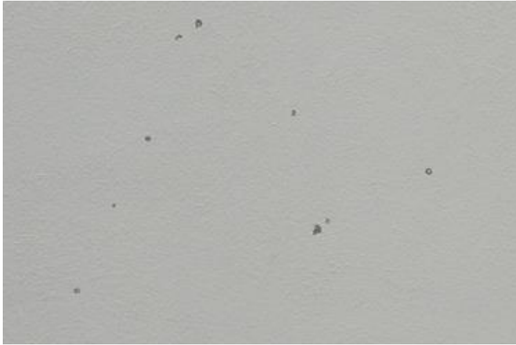
Figur 3.3 Betongfasad med små utspjälkningar, "pop-outs".
