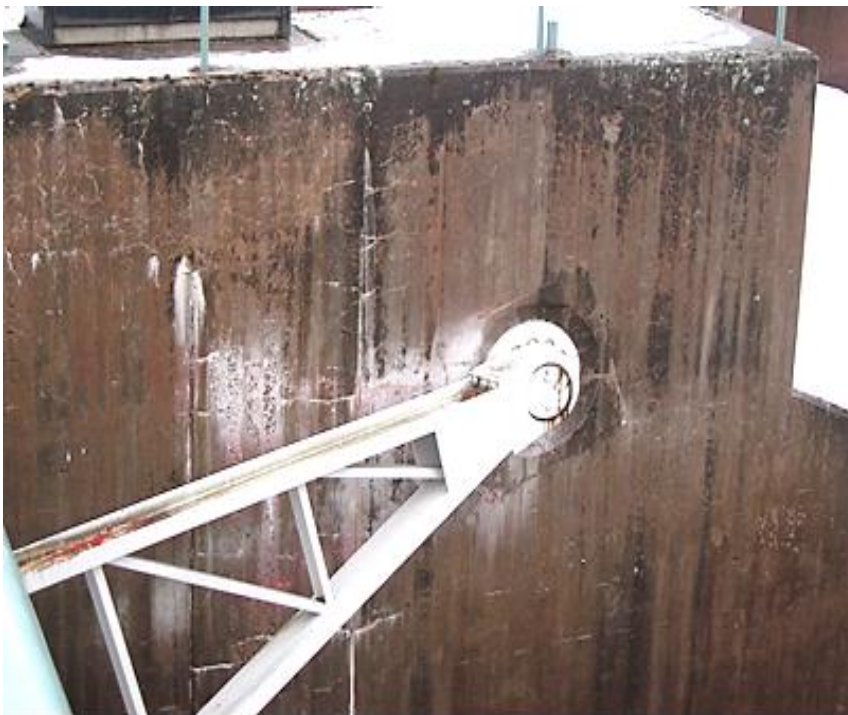
Figur 1.15 Regleringsdamm, Dalarna, från 1956 med sprickor kring dammluckans fäste. Finkorniga metasedimentära bergarter var ett betydande inslag i ballastmaterialet.
