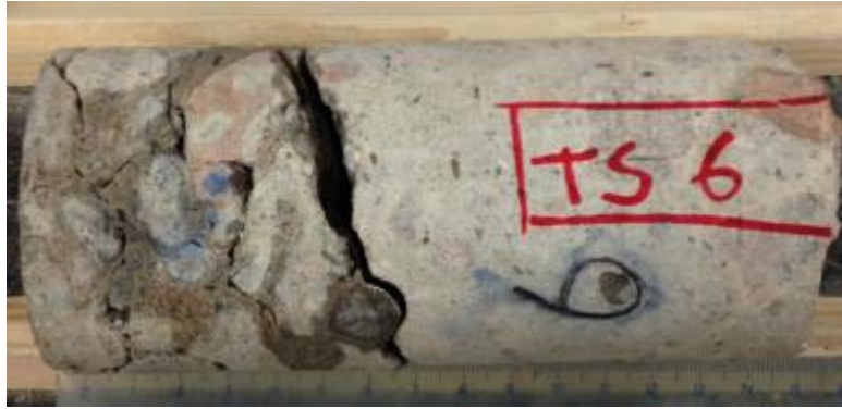
Figur 3.33 Borrkärna tagen från konstruktionen. Mot betongens utsida syns kraftig sprickbildning i betongens tätskikt. Ett armeringsjärn syns i borrkärnans nederkant, där de sammanhängande sprickorna slutar.
