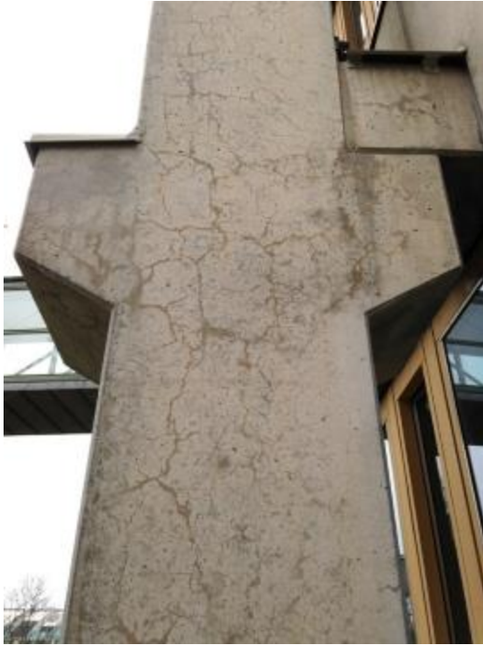
Figur 3.34 ASR-sprickor på en husbyggnads pelare. Pelaren bär upp spännarmerade balkar i huskroppen. På horisontella ytor har betongen skyddats från fukt med plåtbläggningar.
