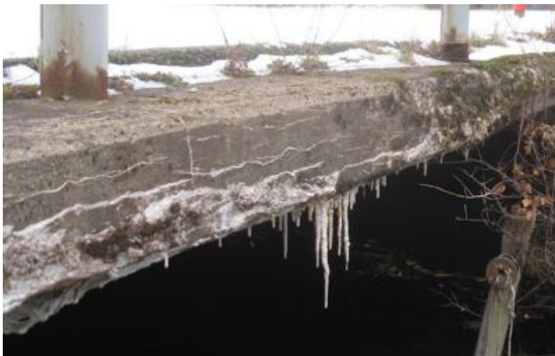
Figur 3.32 Brobana över kraftstation, med kraftig sprickbildning orsakad av en kombination av ASR och frost.
