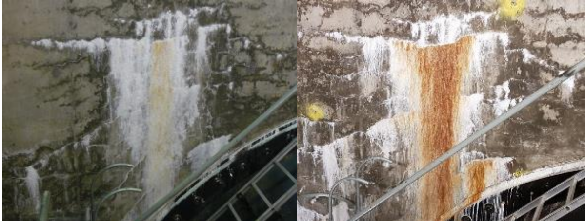
Figur 3.22 Sprickbildning med utfällningar. Utveckling från 2011 till 2018.
