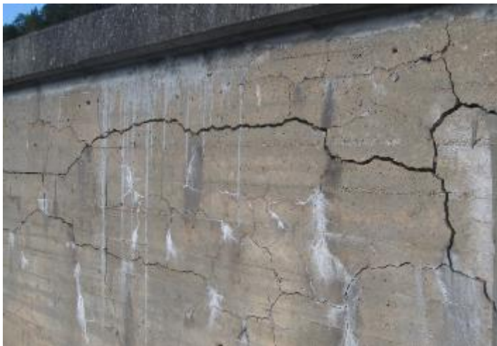
Figur 3.2 Av ASR kraftigt uppsprucken pelare med krackelerat sprickmönster. Pelaren har mycket liten armeringsmängd vilket medför att grova sprickor kan slå upp.
