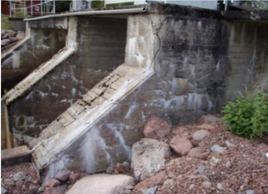
Figur 1.14 Regleringsdamm, Dalarna, från 1953. Kraftig sprickbildning med kalutfällningar som orsakats av ballastmaterial bestående av höga halter av röd kvartsporfyrr (se bildens förgrund).
