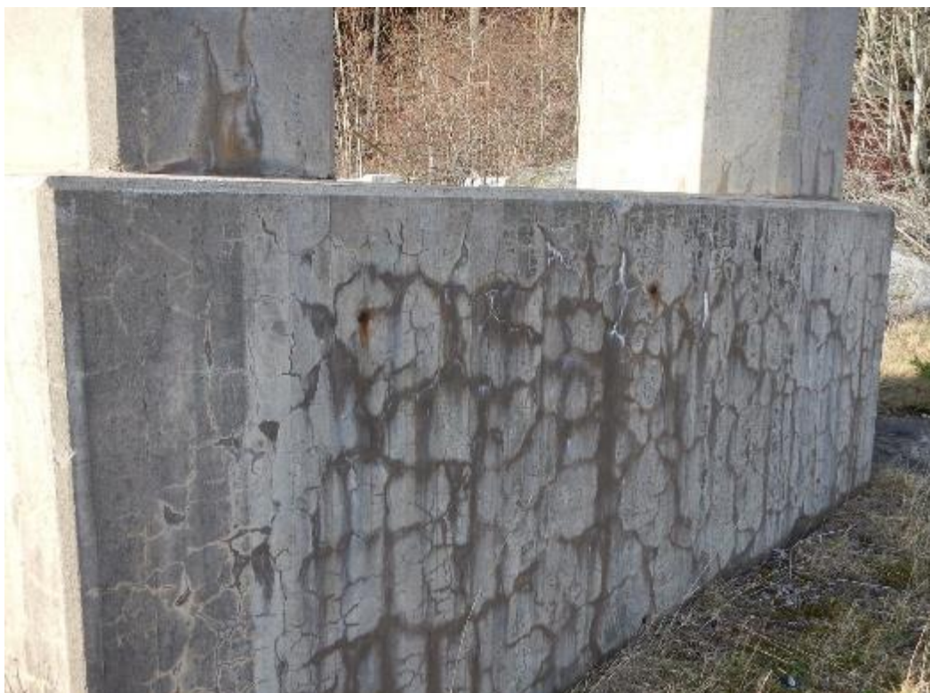
Figur 3.31 Krackeleringsmönster på pelarstöd.
