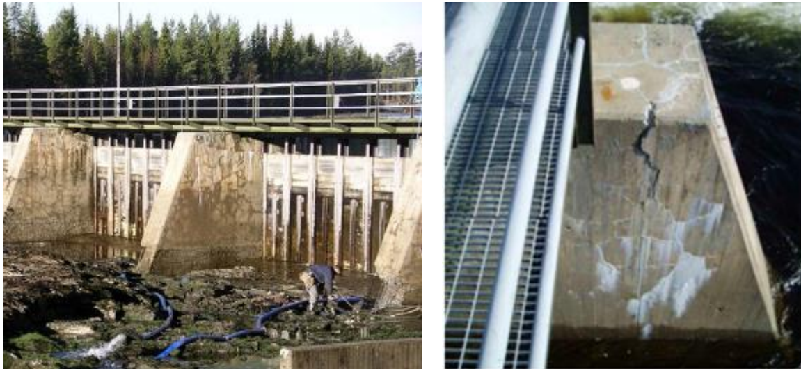
Figur 3.25 a) Översikt utskovsdamm. b) Sprickor i utskovspelare.
