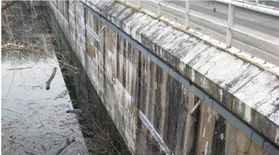
Figur 3.14 Försegling av grova sprickor med remsor av tätande material på betongdamm av massiv typ.
