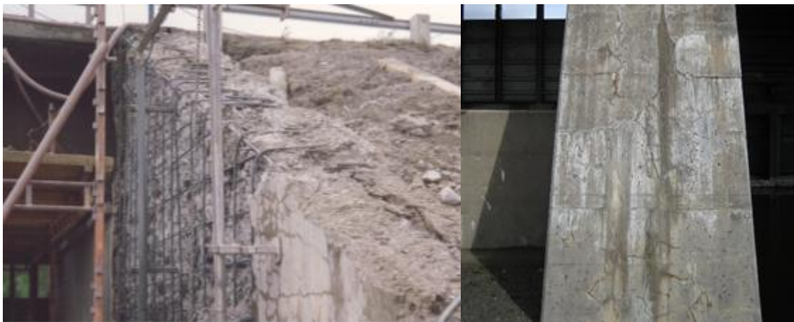
Figur 3.23 Vänster: Reparation av ASR-skadad betong på 90-talet. Höger: Nya skador på 2010-talet.
