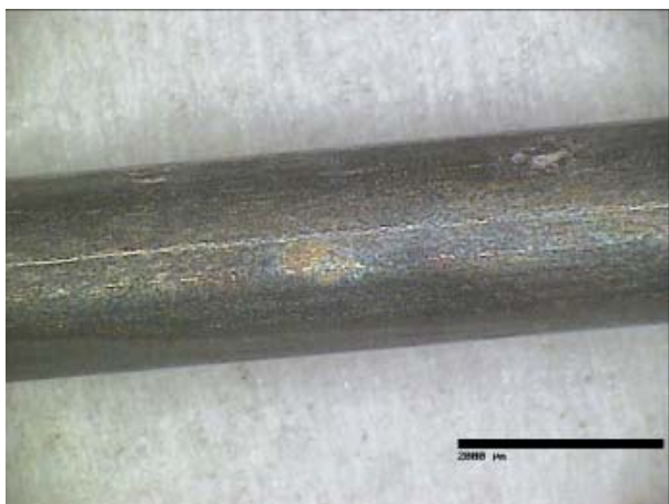
Bild 11. Tråd 32, korrosionshastighet 0,2 µm/år
