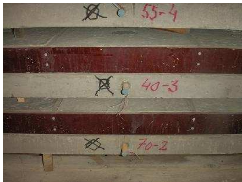
Figur 3 – Foto som visar fuktgivarnas placering i underlagsplattorna.
