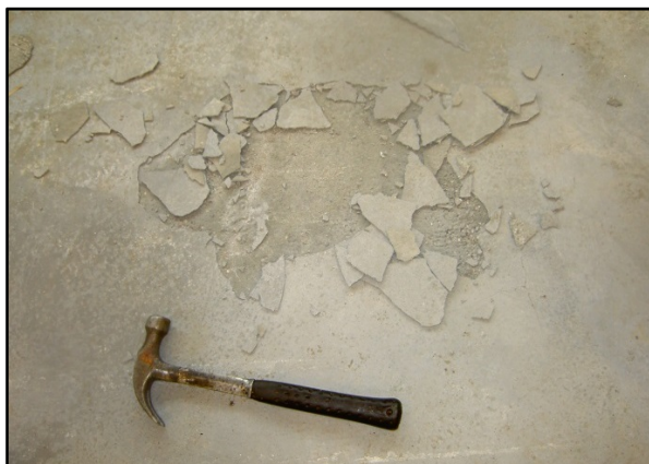
BILD 2. 1-2 mm tunt delaminerat skikt på hårdbetonggolv med strömaterial.
