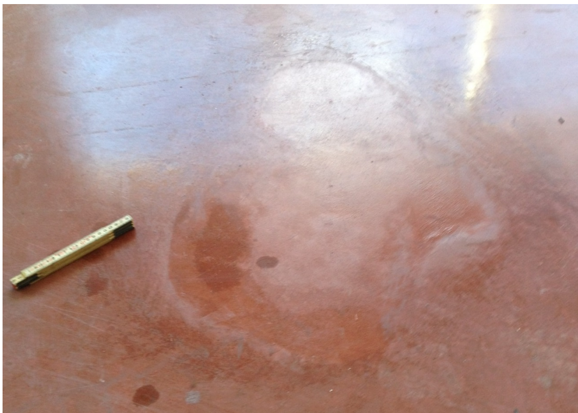
BILD 8. Lagning på ett golv i Gnosjö av en delaminering som upptäcktes efter att golvet hade gjorts färdigt. Lagat med samma material som golvet göts med, Mastertop 135.
