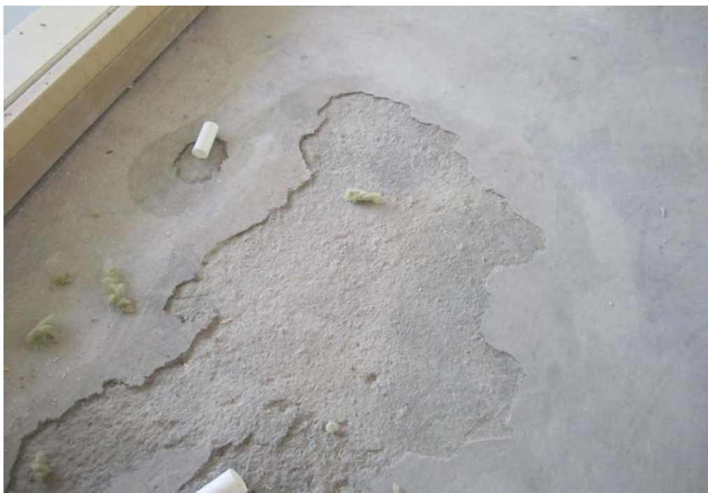
BILD 1. Delaminering på ett glättat konventionellt betonggolv utan ströbetong.
