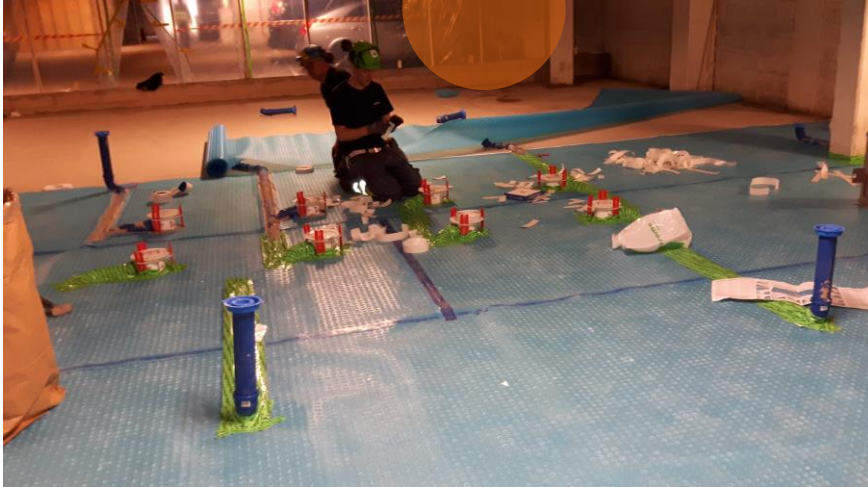
Täckt VA-installation hindrar lukt från att spridas i byggnaden.
