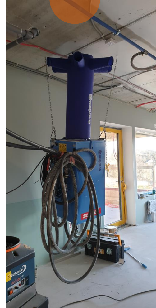
En luftfördelare och torkfläkt som används för uppvärmning och uttorkning.
