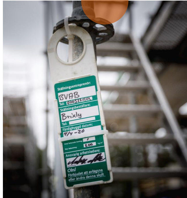
Information fäst på byggnadsställning om vem som är ansvarig, när den var färdigbyggd samt maxbelastning.
