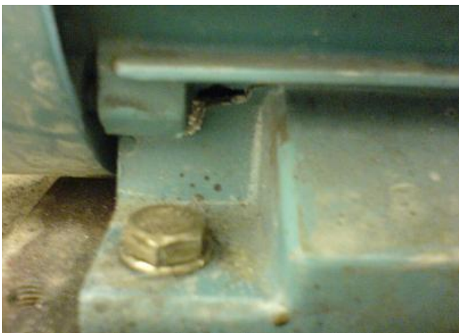
Figur 31. Förslitningsskada på prallmaskin i samband med vibrationer
