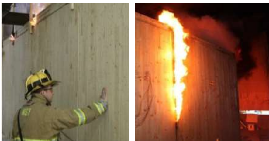
Figur 20. Brandspridning genom en horisontell överlappsfog (t.v.) och genom en vertikal stumfog (t.h.)
