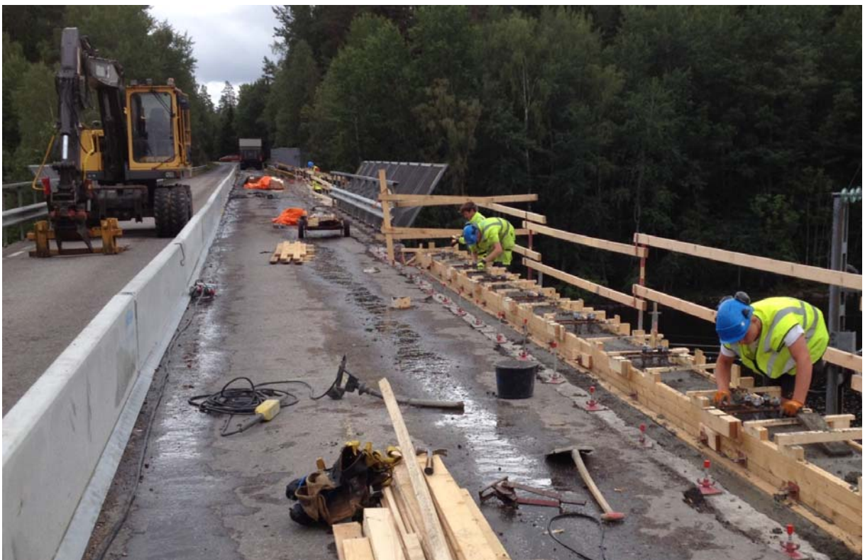
Figur 6.30 Av arbetsmiljöskäl måste utbyte av kantbalkarna till denna smala bro utföras med avstängd trafik. När arbete inte pågår kan ett körfält hållas öppet.
