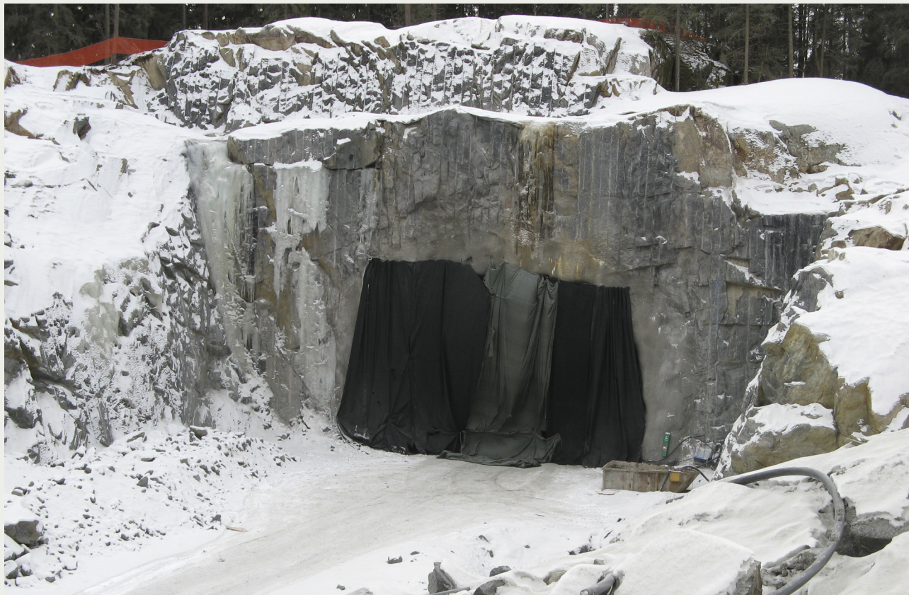
Figur 1. Isbildning i tunnelpåslag.
