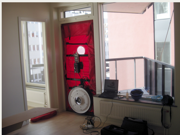
Så kallade "Blowerdoors" är specialtillverkade, mobila dörrar där fläktar kan inmonteras, en eller flera. Dessa dörrar används för att trycksätta bostäder eller lokaler för att därigenom få fram dess täthet (=läckage).
