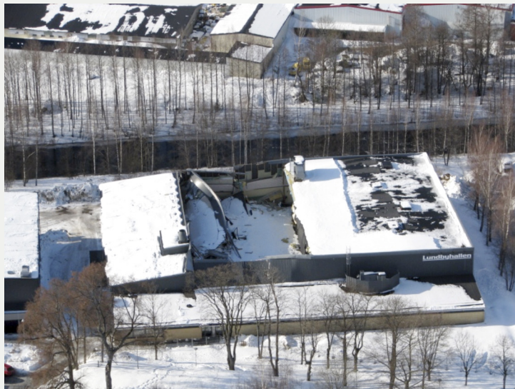
Figur 1. Borås, del av byggnad har kollapsat.
