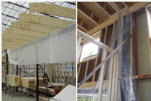
Figur 9 och 10. Två exempel på plastfolie som i tidigt skede applicerats mellan konstruktionsdelar. Figur 9 visar plastfolie mellan takbalkar och bärande balk och figur 10 visar plastfolie mellan yttervägg och lägenhets-skiljande vägg.
