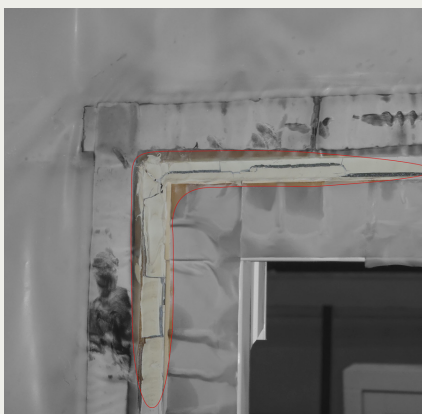
Figur 4. Fogmassan i tätning mellan fönsterkarm och vägg har spruckit och blivit otät.
