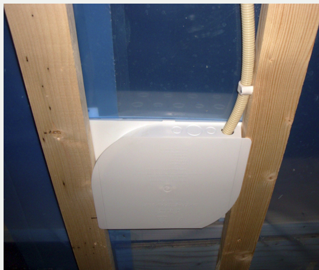
En av många funna detaljlösningar, en förbättrad installationslåda för spotlights.
