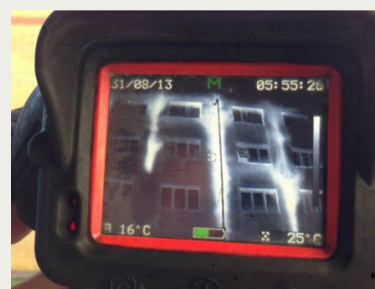
Figur 1. Brandspridning neråt i modulskarvar, bild med IR kamera.
