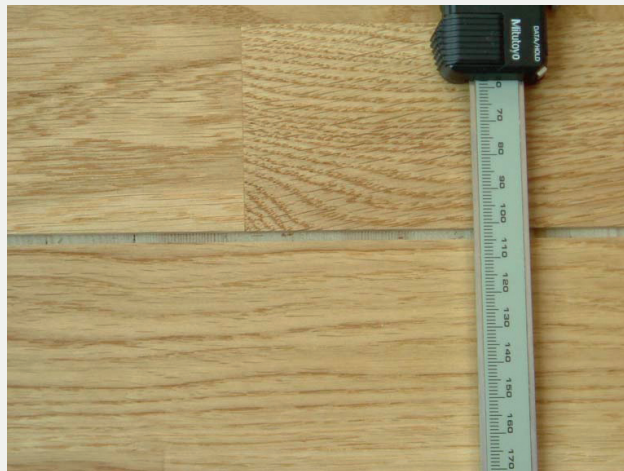
Springa mellan lamellparkettbräder med limmad fog. Skadan har orsakats av att golvet lagts sammanhängande utan rörelsefogar mellan olika rum.
