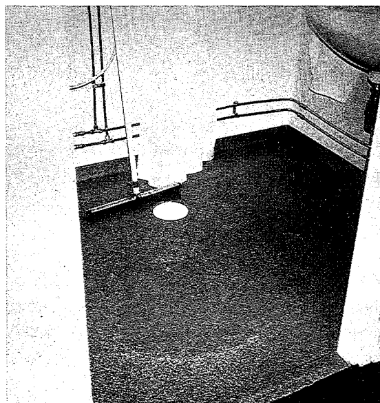
BAKFALL I DUSCHRUM
