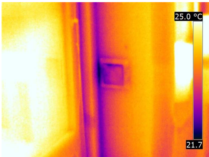
Termogram 4. Luftläckage vid strömbrytare i smyg.
