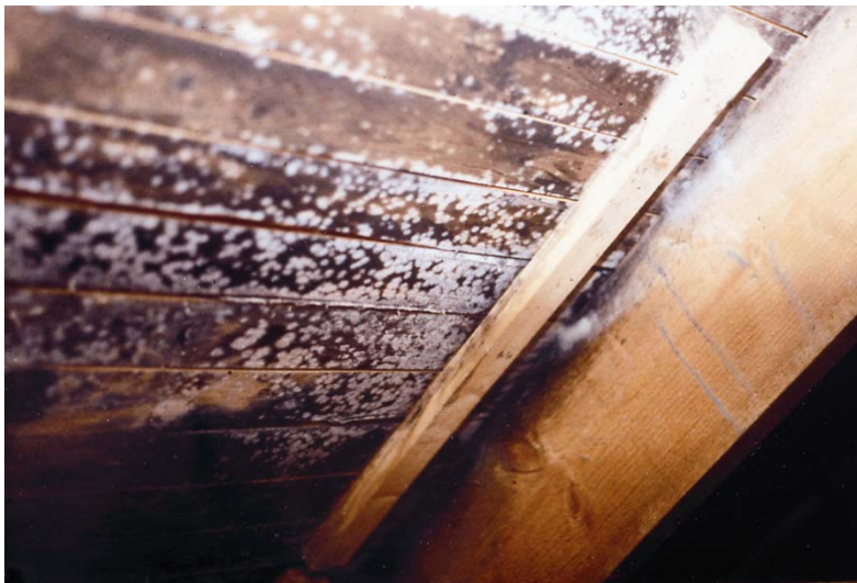
Figur 37. Exempel på fuktskadad kallvind.
