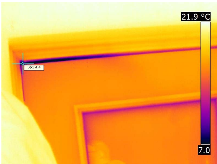
Termogram 5. Luftläckage i anslutning mellan dörrblad och karmöverstycke vid ytterdörr i pannrum. Detta läckage förekom ej juli 2013.
